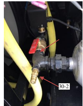
30- Vanne d'isolement de la pompe (ouvert) & coupleur rapide de remplissage / vidange
